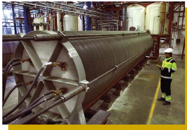
Figura 34. Electrolizador Alcalino de 2 MW.
