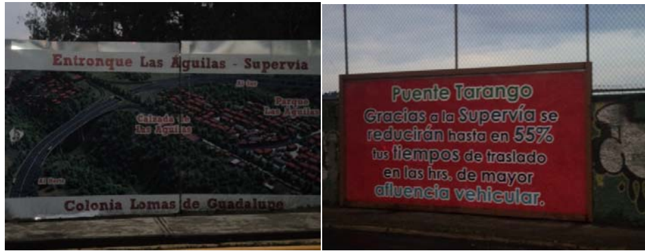
Construcción de la supervía a la altura de Parque Tarango y Av. Las Águilas, 2012
