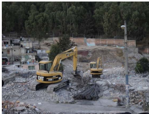
"Zona Cero", casas derrumbadas en la colonia La Malinche, límite Magdalena Contreras y Álvaro Obregón, 2010
