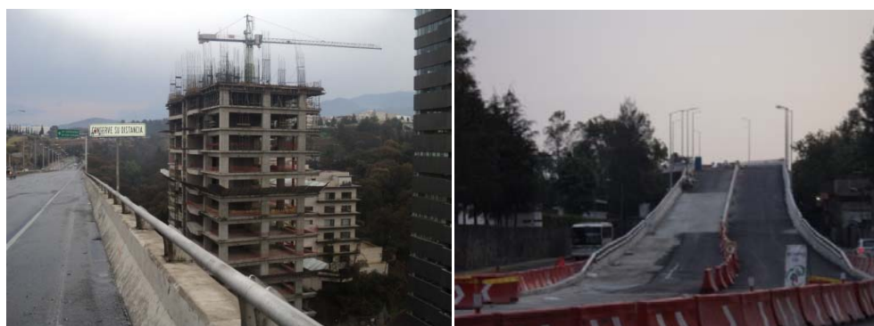
Construcción Puente de los Poetas, 2012 Construcción supervía poniente en Av. Luis Cabrera, octubre de 2012
