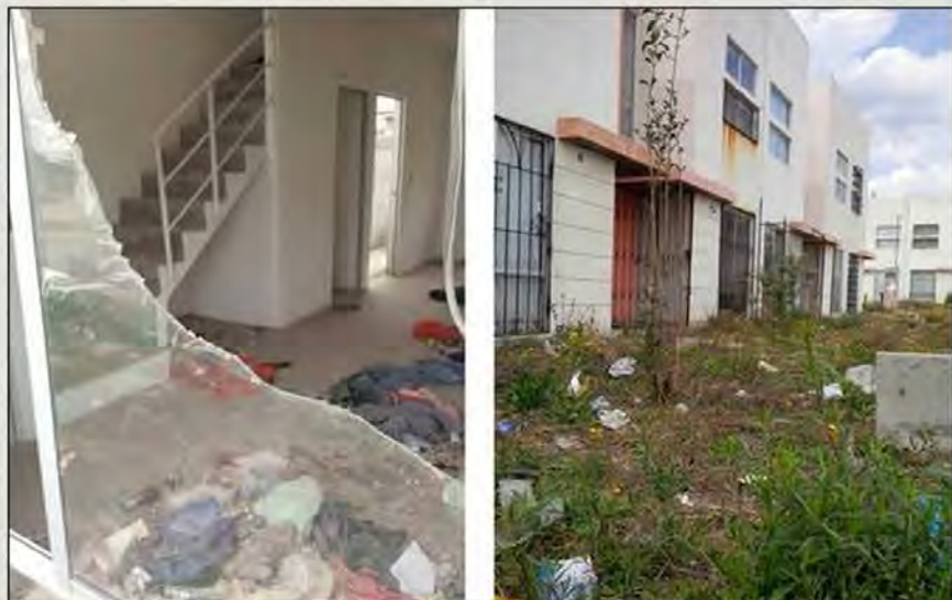
Viviendas abandonadas en el fraccionamiento Santa Teresa, municipio de Huehuetoca, estado de México, donde la empresa inmobiliaria Homex, declarada en quiebra, no proporcionó servicios básicos ◉ Foto Silvia Chávez
