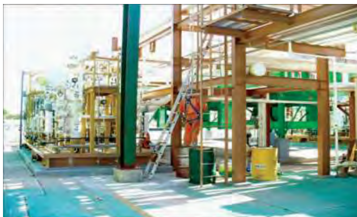
Figura 5.8 Procedimiento, orden y limpieza (Auditorias Efectivas PEMEX-SSPA, 2010)
