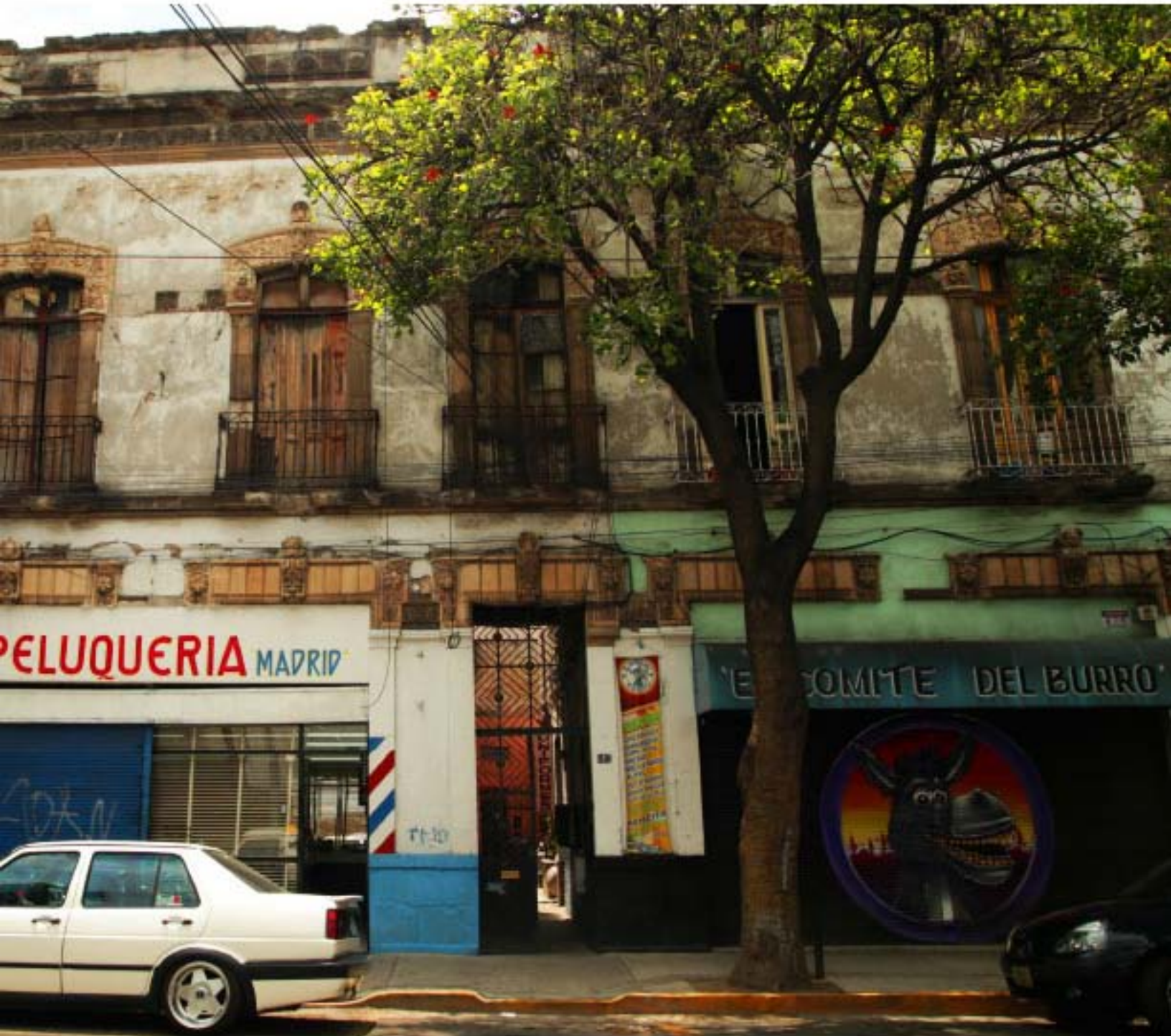
Fachada de casa en abandono y locales en planta baja. Ubicación calle Jaime Torres Bodet, col. Santa María la Ribera. Fotografía por Francisco Mercado, mayo 2015.
