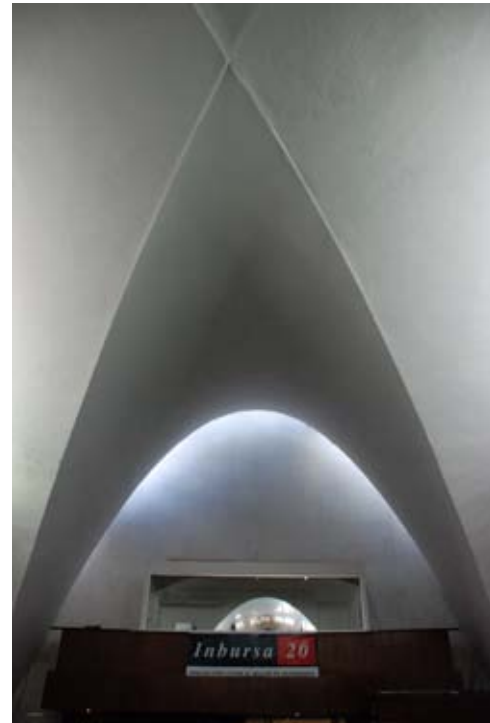
Bóveda por arista de la sala de remates en la antigua Bolsa Mexicana de Valores.
