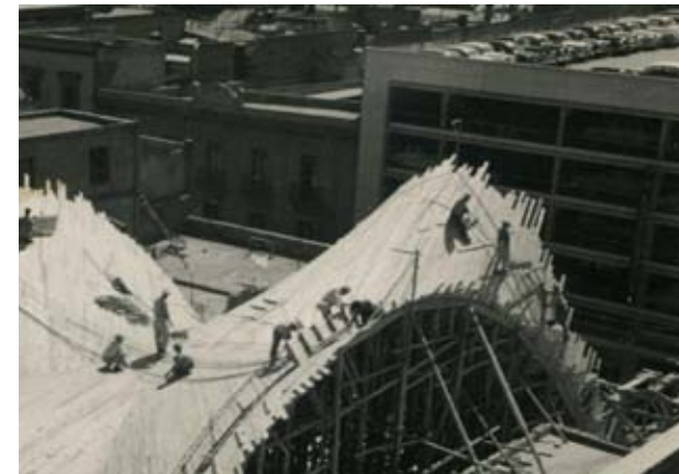
Frente a la construcción de la bóveda por arista con paraboloides hiperbólicos de la Bolsa de Valores se observa el edificio de estacionamiento sobre República de Uruguay. Imagen obtenida de la red.
