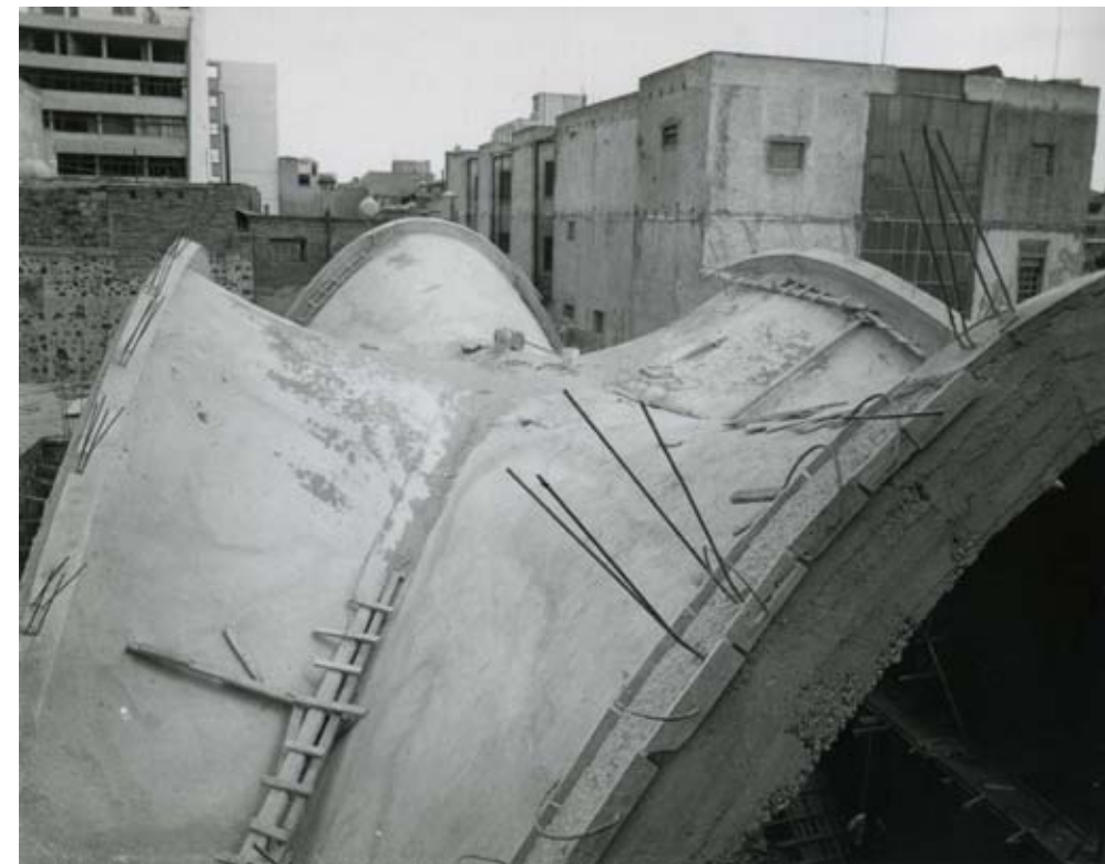
Proceso constructivo de la bóveda por arista con paraboloides hiperbólicos de la Bolsa Mexicana de Valores. Imágenes obtenidas del documento Las bóvedas por arista: una aportación a la historia de la construcción. El caso de la Bolsa Mexicana de valores del Dr. Arq. Juan Ignacio del Cueto Ruiz-Funes.
