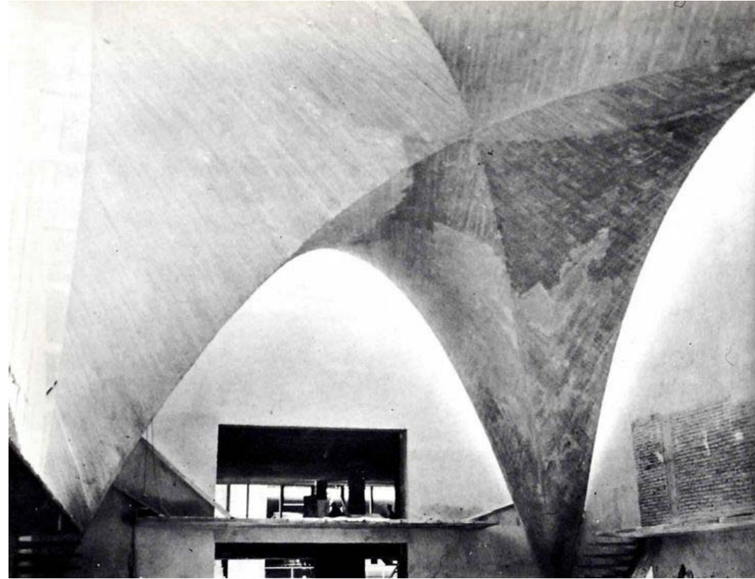
Interior de la sala de remates durante la construcción del edificio de la Bolsa Mexicana de Valores. Imagen obtenida de la red.
