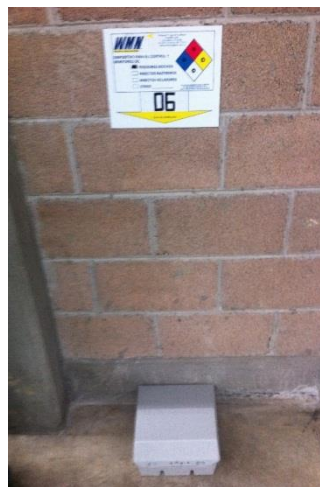
Figura 7. Control de plagas para roedores así como para insectos voladores
