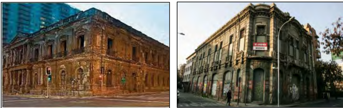
Figura 2.6 Santiago: palacios abandonados y degradados en el Centro Histórico
