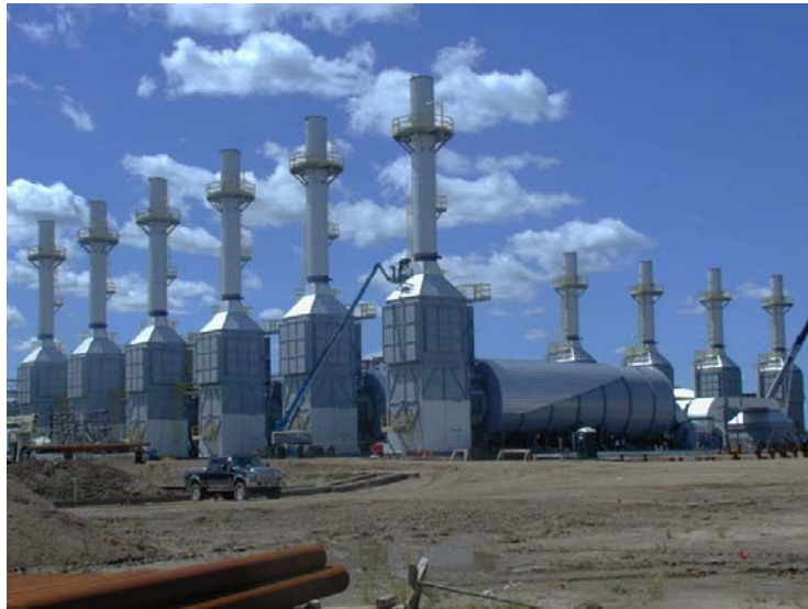
Ilustración 12-Generadores de vapor (Tomada de : http://www.tiwwestern.com/once-through-steam-generators/image?view=image&format=raw&type=orig&id=35 )
