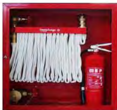
Gabinete contra incendios
