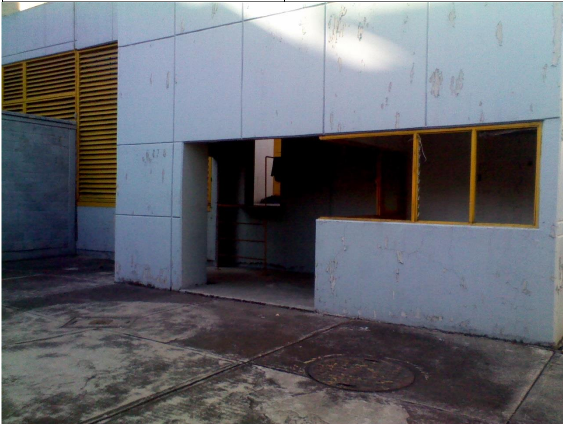
Figura 4-4 Entrada a la Subestación de rectificación.
