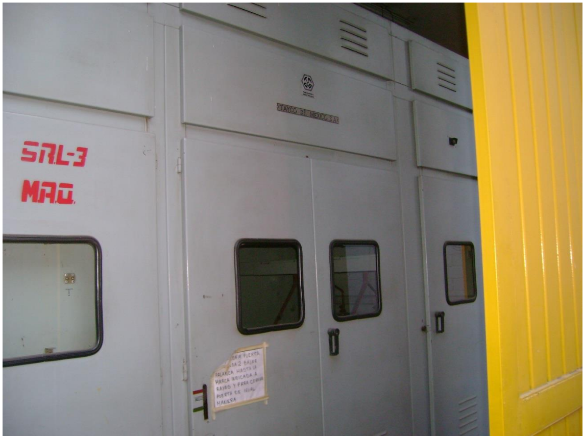
Figura 4-8 Gabinete de Alta Tensión.
