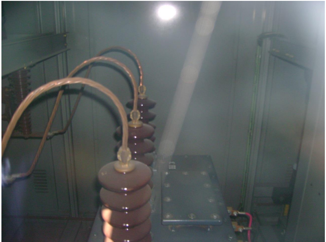
Figura 4-12 Transformador auxiliar (TX)
