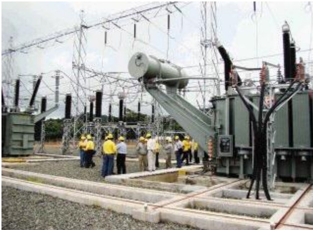
Figura 2-7 Ejemplo de una subestación de intemperie.
