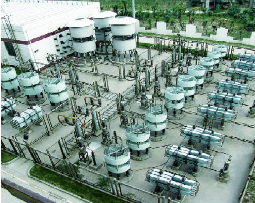
Figura 2-2 Compensador dinámico de potencia reactiva.
