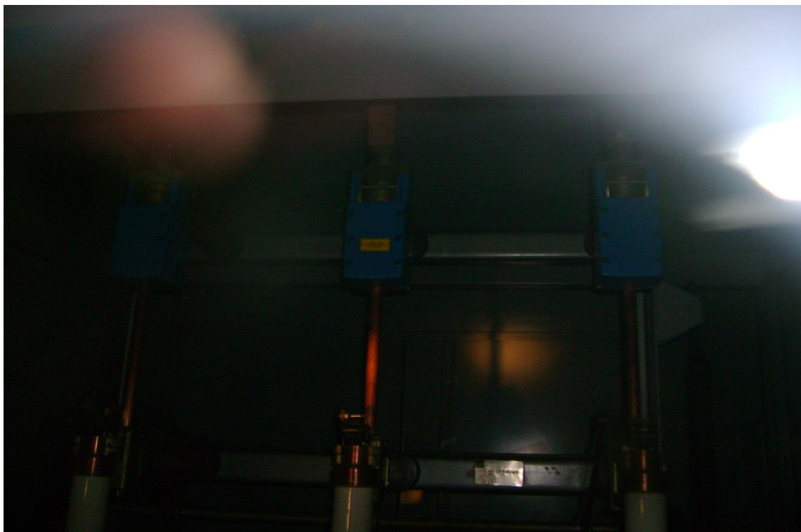
Figura 4-9 cámaras de extinción de arco en aire.
