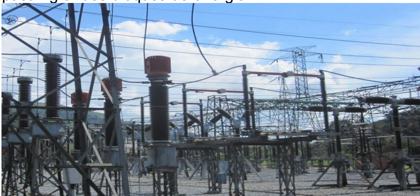
Figura 2-4 Subestación eléctrica de Texcoco.
