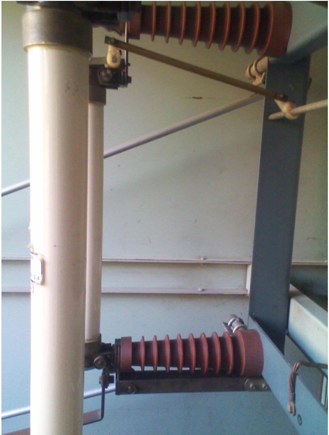
Figura 4-10 Fusibles para el transformador Tx.
