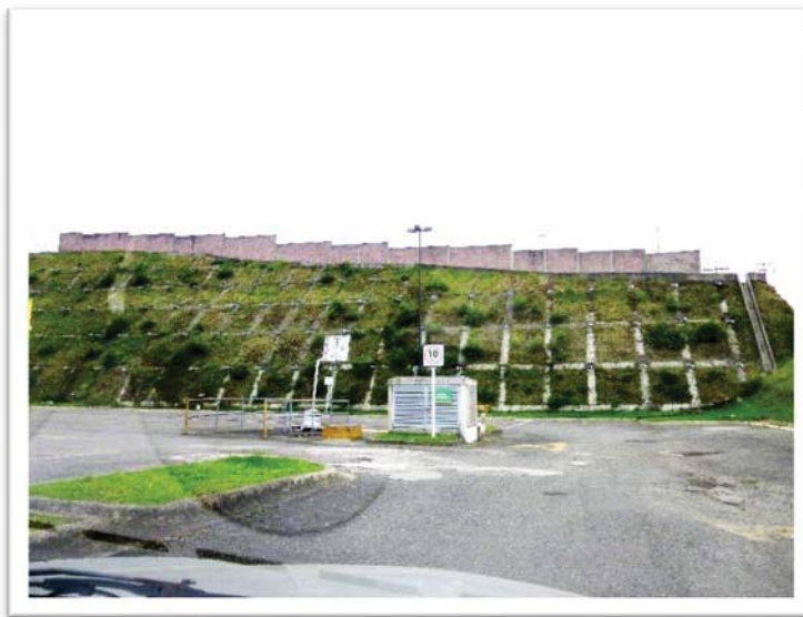
Figura 3.21. Ejemplo de estabilidad de laderas en estacionamiento de Aurrera, Teziutlán, Pue. Octubre de 2015. Fotografía tomada por Felipe Juárez.
