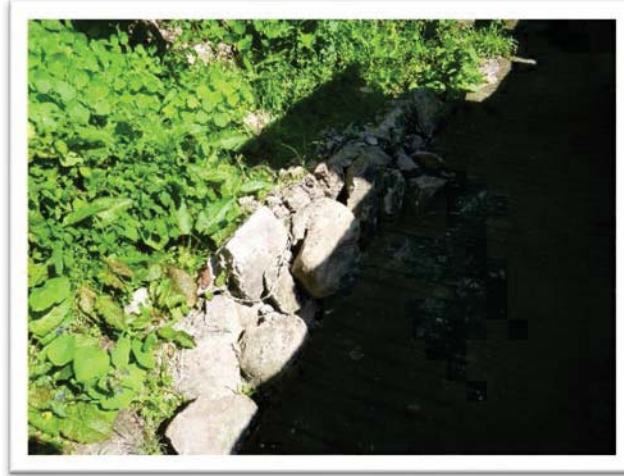
Figura 4.15 Caída de rocas en el segundo corredor en la colonia Juárez. Octubre de 2015. Fotografía tomada por Felipe Juárez.
