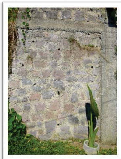
Figura. 4.24. Muro de contención con drenes en la colonia Juárez, Teziutlán, Pue. Octubre 2015. Fotografía tomada por Felipe Juárez.
