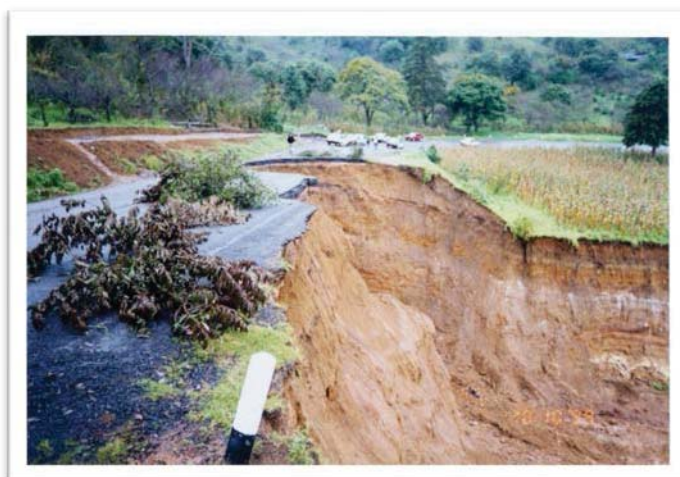
Figura. 3.1. Afectaciones en carretera Atempan-Teziutlán, Pue Octubre 1999. Fotografía tomada por Seguridad Pública, Teziutlán.
