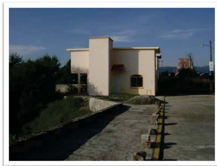
Figura. 3.11. Vivienda construida sobre una ladera inestable, colonia San Andrés, Teziutlán, Pue. Junio 2013. Fotografía tomada por Felipe Juárez.
