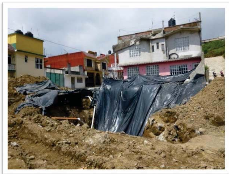
Figura. 3.24. Casa colapsada en la colonia El Paraíso, Teziutlán, Pue. Octubre de 20115. Fotografía tomada por Felipe Juárez.
