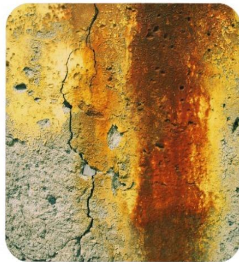
Figura 2.3 Concreto deteriorado debido al agrietamiento [26].
