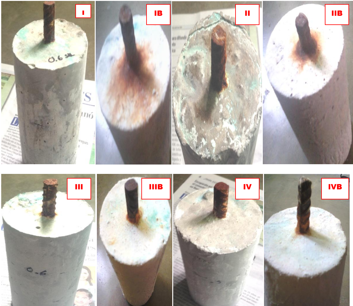
FIGURA 4.10 Comparativo del deterioro del acero de refuerzo en las probetas con misma relación agua-cemento
