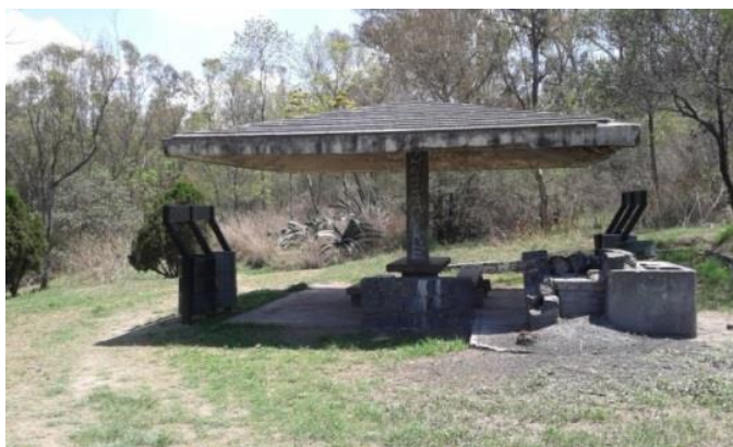
Imagen 78. Fotografía que muestra uno de los sanitarios ubicados en la tercera sección, los cuales están deteriorados y abandonados. Fuente: propia (enero de 2013)
