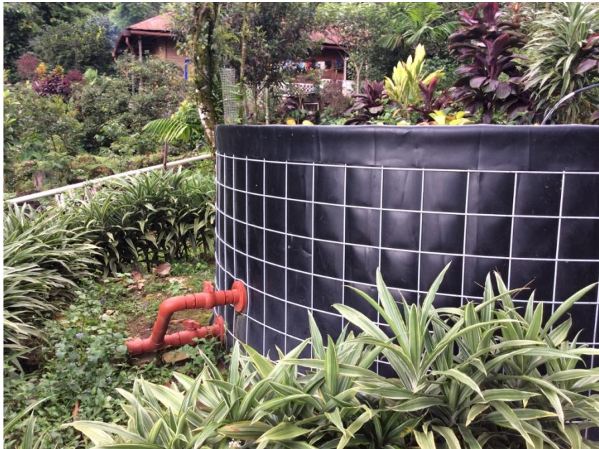
Figura 6.17 Válvulas de salida de las lagunas de estabilización
