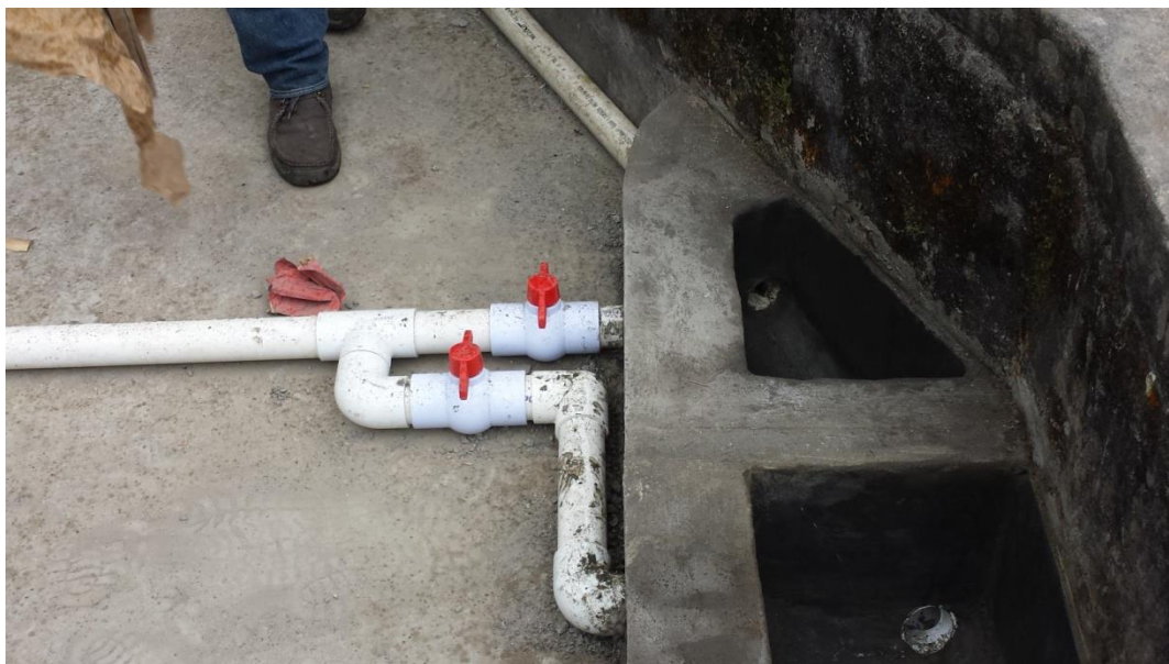
Figura 6.14 Registros y válvulas de cambio de dirección de flujo de agua tratada
