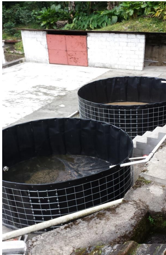
Figura 6.10 Tanques de tratamiento secundario
