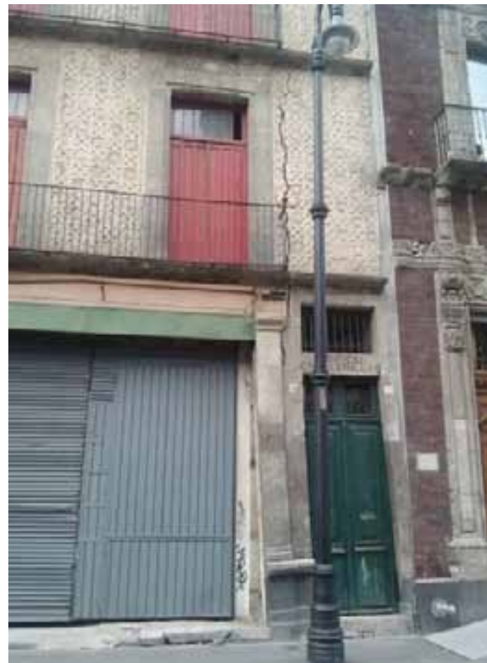
La fachada no se encuentra en su estado ideal.
