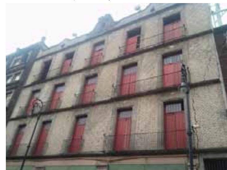
La fachada no se encuentra en su estado ideal.
