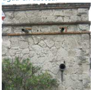
Escurrimientos en fachadas por instalación de gárgolas.
