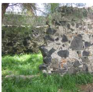
Derrumbe de barda de piedra brasa.
