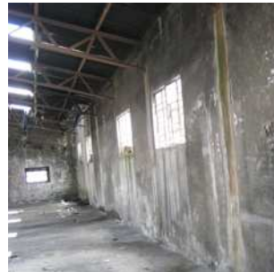
Escurrimientos en muros por filtración en cubiertas.
