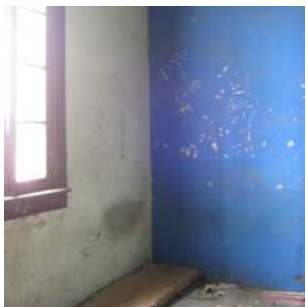
Suciedad en muros interiores.
