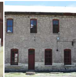
Instalaciones en fachada
