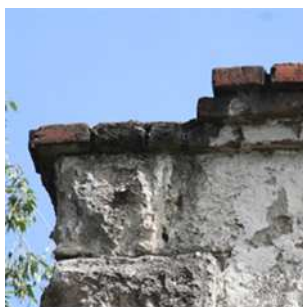
Pérdida de cornisas de ladrillo.
