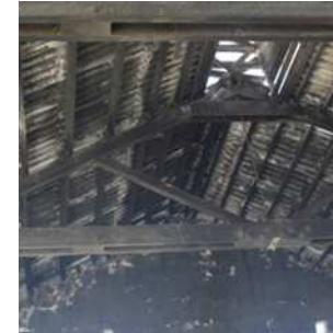
Pérdida de resistencia en estructura de madera por hongos.
