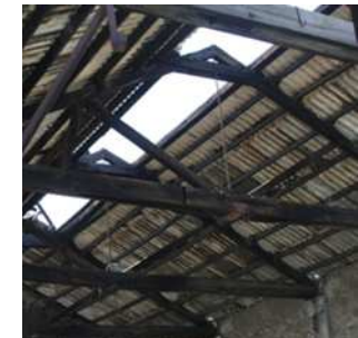
Pérdida de láminas por deterioro de los sujetadores.
