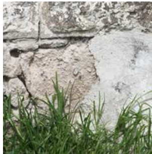
Pérdida de aplanados de cal.
