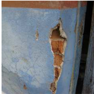
Pérdida de aplanados por filtración de agua de lluvia.
