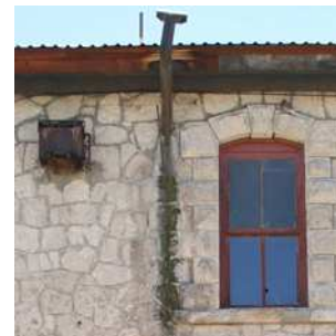
Escurremientos y perforaciones
