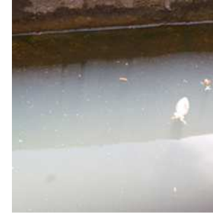
Falta de desagüe en fosas de inspección.
