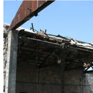
Pérdida de sistema de cubiertas por deterioro en armaduras.
