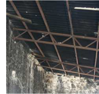
Deterioro en cubiertas de lámina.
