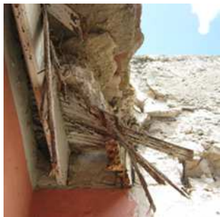
Desplome de cubiertas por acumulación de agua en azotea.
