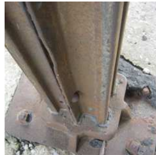
Óxido en estructura metálica por penetración de lluvia.
