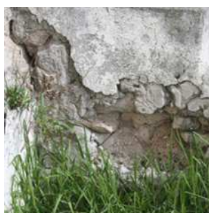
Erosión de aplanados y cantera en muros.
