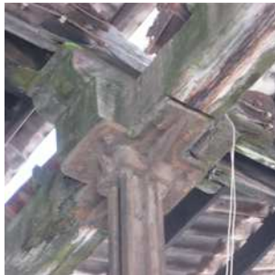
Humedad y hongos en armaduras de madera.
