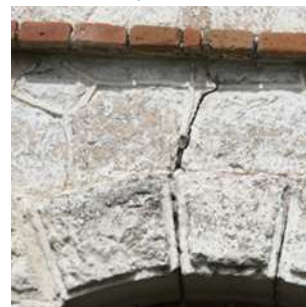
Agrietamiento en muros por pérdida de cubiertas.
