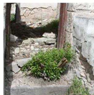
Crecimiento de flora que provoca el levantamiento de pisos.
