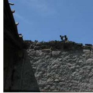
Vegetación parásita en muros de piedra.
