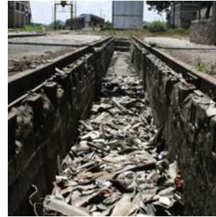
Acumulación de desechos en fosas de inspección.
