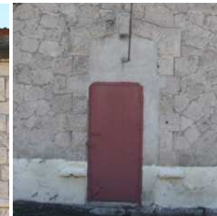
Alteración de vanos
