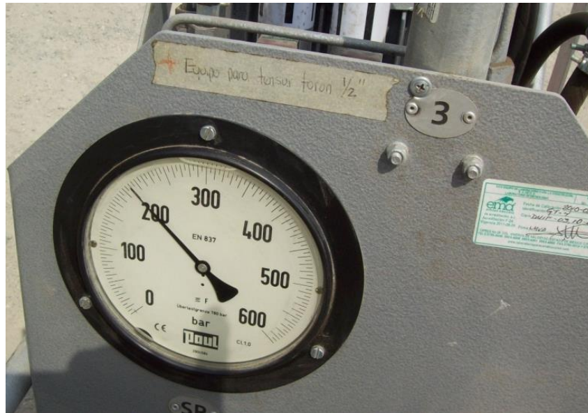
Figura IV.3.11.A Manómetro (Foto tomada por el autor)
