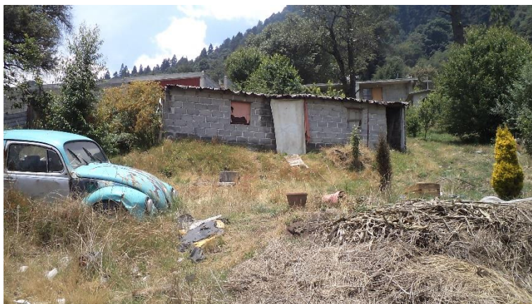
Figura 4.57. Fotografía E de la Zona 6, Se observa la vivienda en la parte baja de la ladera, presenta deformación como si estuviera teniendo un movimiento hacia el centro de la construcción.
