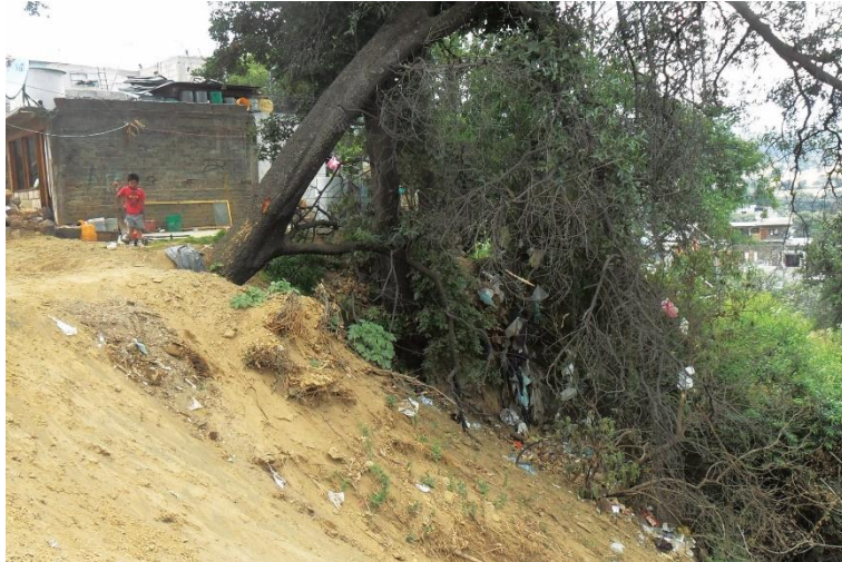
Figura 4.39. Fotografía A de la Zona 3, los materiales finos como los limos y las arcillas que componen el suelo de esta ladera son desestabilizados al realizar taludes por lo que son removidos con facilidad. Prueba de ello es el árbol que presenta una fuerte inclinación en favor de la pendiente.
