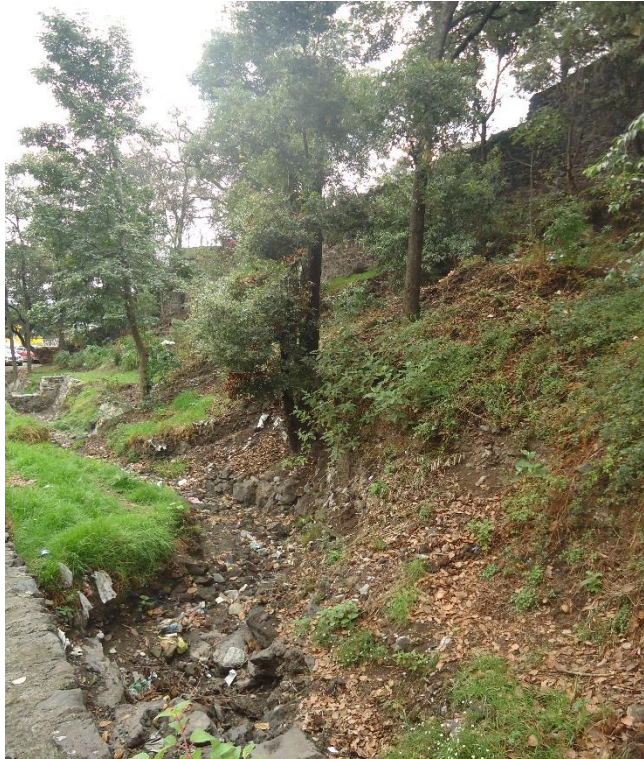
Figura 5.68. Fotografía A de la Zona 8, socavación producida por la corriente de agua y como debilita la ladera facilitando la ocurrencia de derrumbes.
