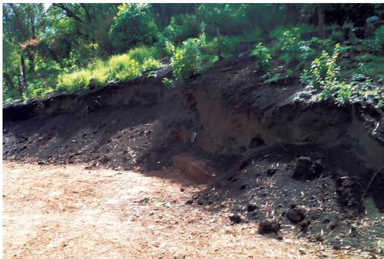
Figura 4.50. Fotografía B de la Zona 5, el material que compone la ladera (principalmente ceniza y suelos arcillosos) no se encuentra consolidado por lo que los cortes provocan derrumbes y acumulación de material en las orillas de los caminos.
