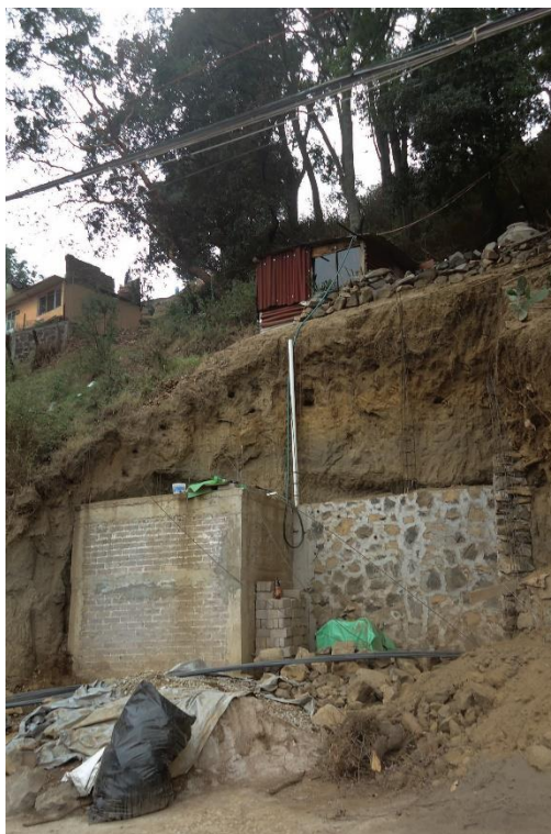
Figura 4.40. Fotografía B de la Zona 3, se aprecia el corte en la ladera y los depósitos compuestos por suelo y bloques de distintos tamaños que representan un peligro alto por derrumbe para la construcción que se encuentra en la parte baja de la fotografía.
