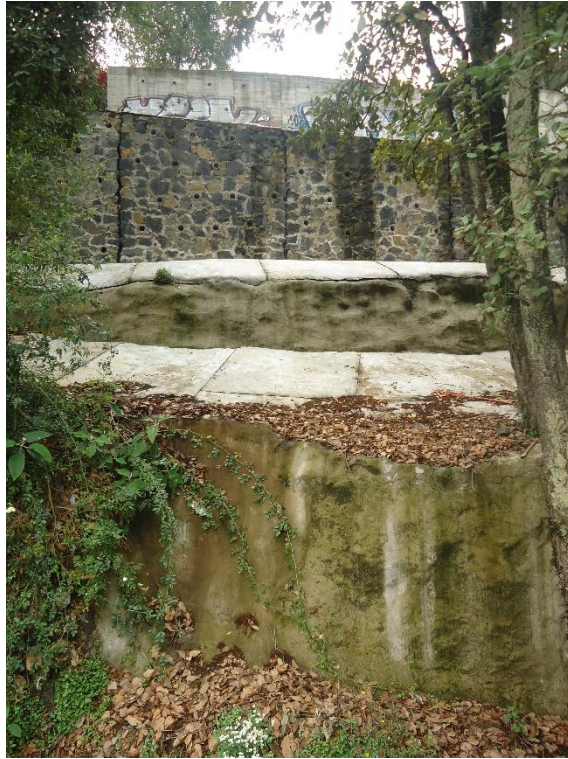
Figura 5.69. Fotografía B de la Zona 8, parte baja del muro de contención en la calle Río Seco.
