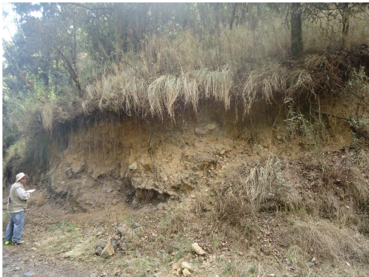
Figura 4.44. Fotografía B de la Zona 4, se observa como ya hay rocas en la parte baja que han caído de partes más altas, lo cual demuestra la inestabilidad del corte.
