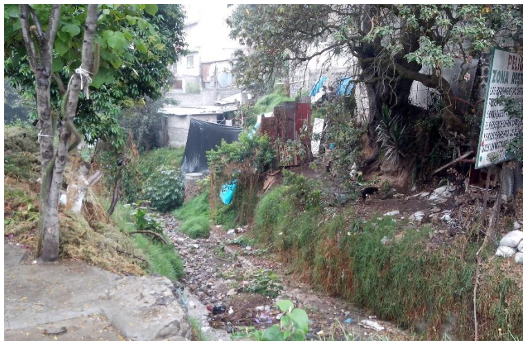
Figura 4.60. Fotografía B de la Zona 7, la pared de la barranca presenta inestabilidad, causada por la socavación de las bajadas de agua que se presentan en ella.
