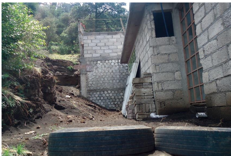
Figura 4.52. Fotografía D de la Zona 5, vivienda en construcción. De lado izquierdo hay un talud, de origen antrópico, con un deslizamiento de ceniza. También se puede apreciar que la construcción no tiene castillos en las esquinas.
