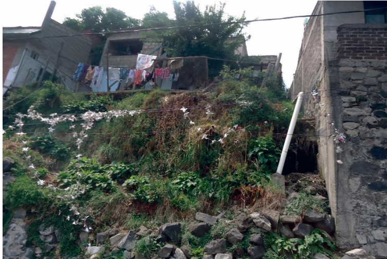
Figura 4.16. Fotografía G de la Zona 1, vivienda que comienza a tener pérdida de su basamento debido a la remoción de los materiales del talud en el que se encuentra.
