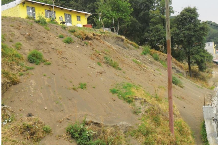
Figura 4.10. Fotografía A de la zona 1, se aprecia la erosión de la ladera y el consecuente desplazamiento de cenizas ladera abajo, y el peligro que representa para la vivienda al estar perdiendo su basamento.
