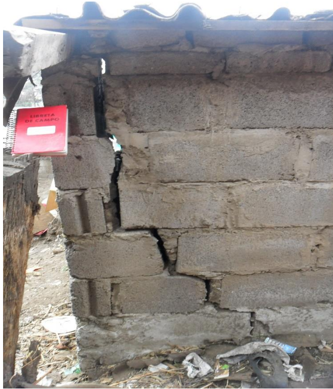
Figura 4.30. Fotografía G de la Zona 2, vivienda desplantada sobre la ladera que presenta deslizamiento, la cual presenta una fractura en uno de sus muros.
