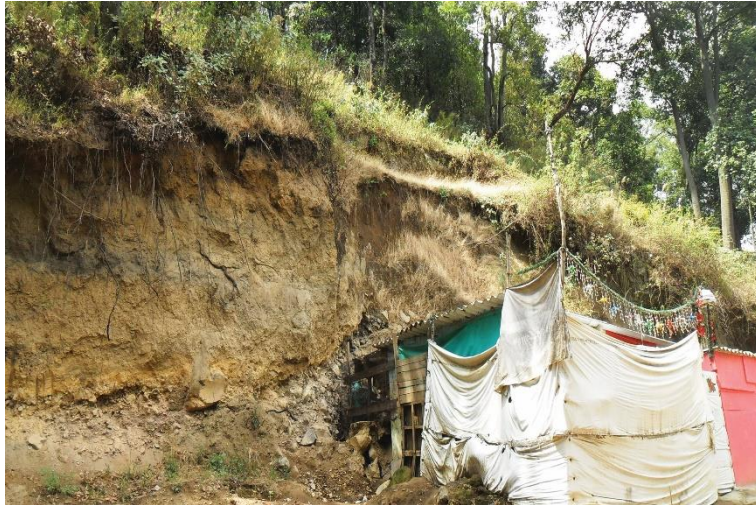
Figura 4.46. Fotografía D de la Zona 4, vivienda hecha de madera y lamina, construida frente a un talud de material inestable y fácilmente erosionable. Esta vivienda se vería muy afectada ante un derrumbe o deslizamiento.
