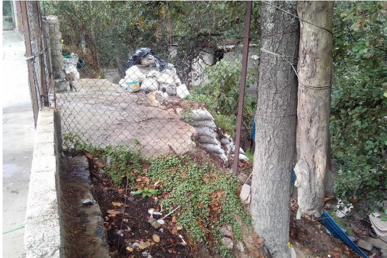
Figura 4.60. Fotografía C de la Zona 7, ruinas de una construcción desplantada sobre una pendiente que sufrió desprendimiento de material.
