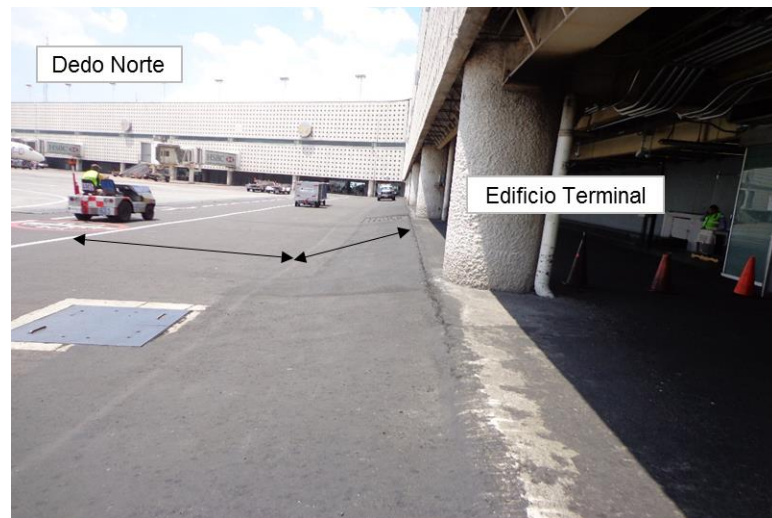
Figura 2. 6 Asentamiento diferencial entre el Edificio Terminal y el Dedo Norte del Aeropuerto Internacional de la Ciudad de México, Terminal 2
