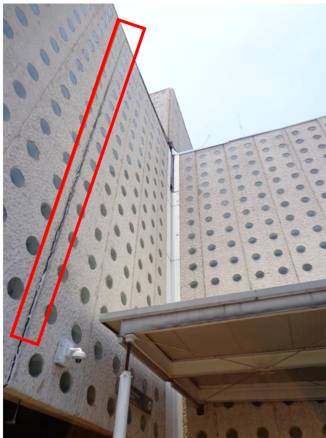
Figura 6. 11. Grieta a lo largo de los paneles de concreto del Dedo Sur
