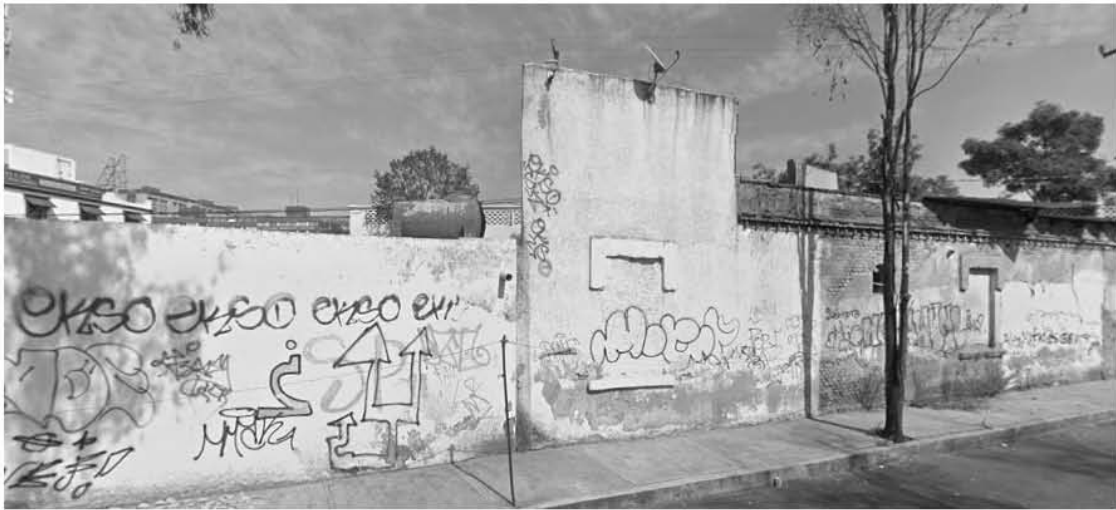
El predio tiene un intenso flujo vehicular a los lados. FUENTE: Google Images
