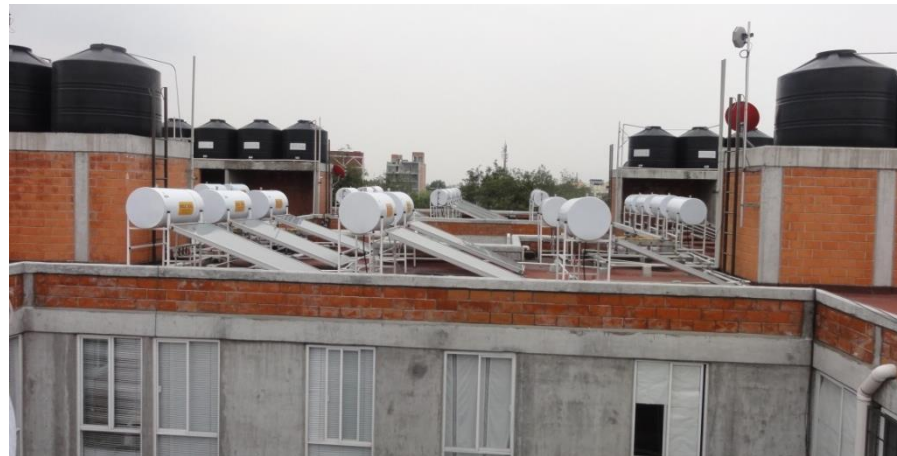
Fig. 82. Imágenes de las ecotécnicas del Conjunto Habitacional Municipio Libre 171 (Calentador solar y Cisterna de agua pluvial) Fuente: Elaboración propia, fotos tomadas durante el recorrido de campo.
