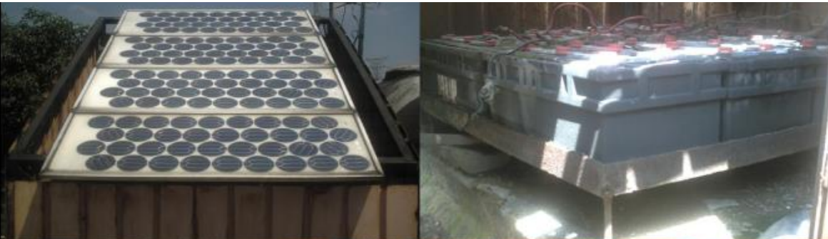
Fig. 15 Fotoceldas desconectadas en el edificio Helios del Conjunto Ecológico Pedregal Imán V. Fuente: Figueroa Jiménez 2009
