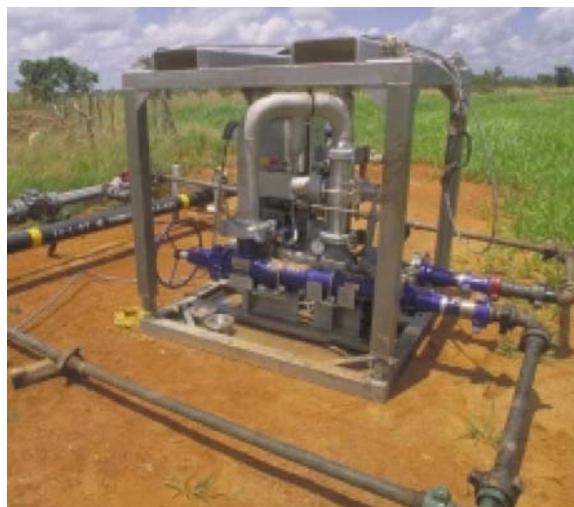
Figura 21. Medidor multifásico montado sobre un patín 9
