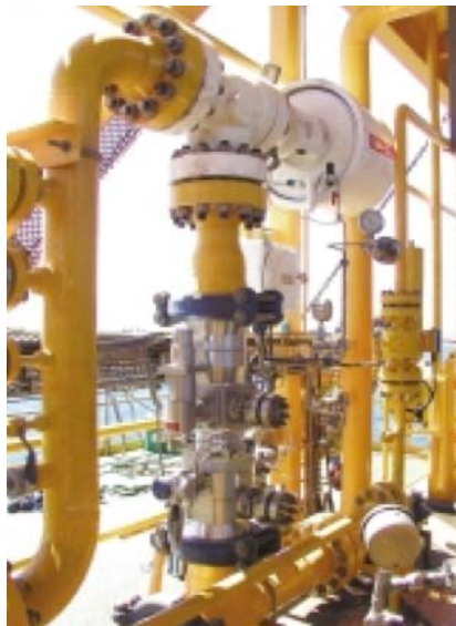
Figura 20. Medidor multifásico montado en las líneas de producción 9
