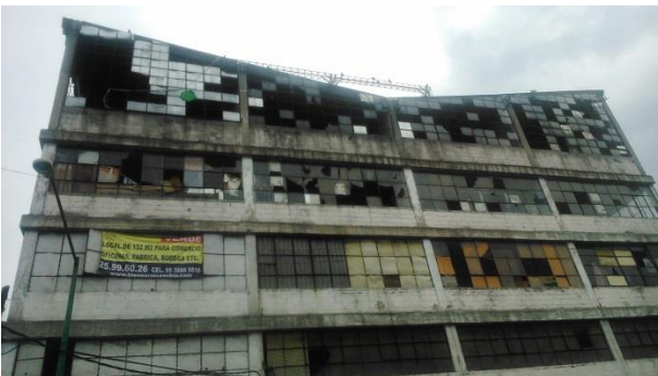
Deterioro y abandono de los inmuebles residenciales. Colonia Morelos.
