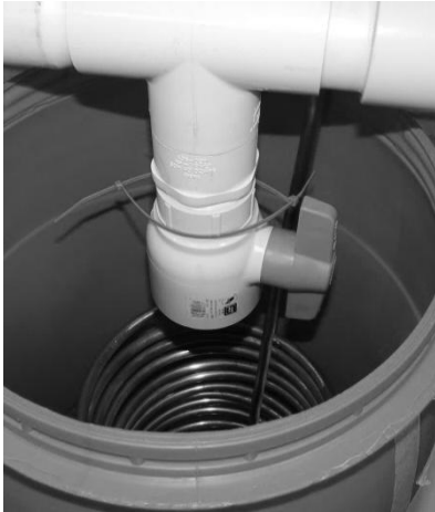
Fig. 16 Serpentin dentro del tanque
