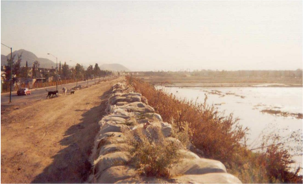
Foto F10. Vista sobre la colindancia oriente, se aprecia un talud de “costalera” colocado por los vecinos al anegarse el agua, tratando de evitar que esta se desborde.
