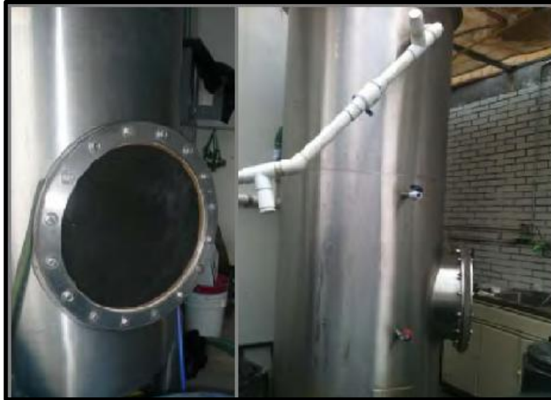
Figura 3.13 Primer Reactor R-1 anaerobio de la planta de biogás (Grimaldo, 2013)
