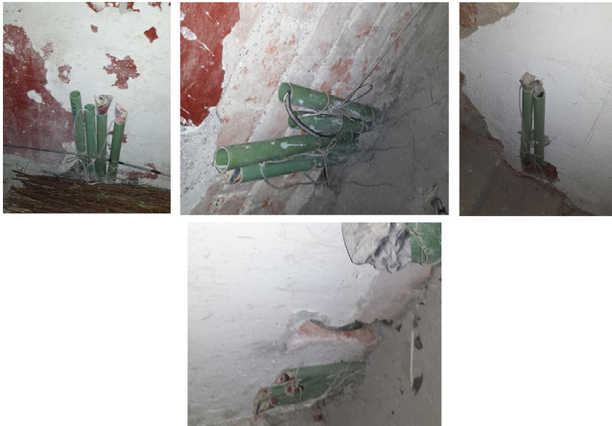
Figura 2. 5 Canalización existente para un ala de oficinas
