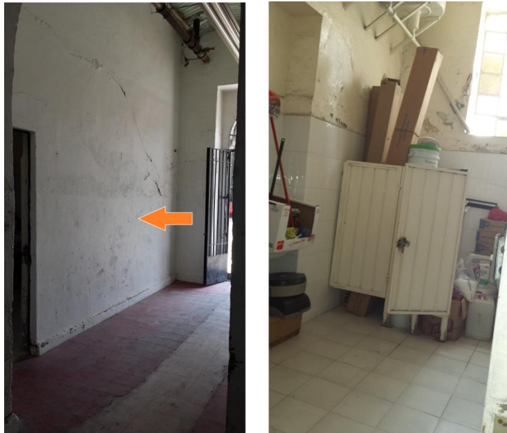
Figura 2. 4 La imagen de la izquierda muestra el muro que será demolido para la construcción de las nuevas escaleras. La imagen de la derecha muestra el cuarto el cual se modificará para las nuevas escaleras
