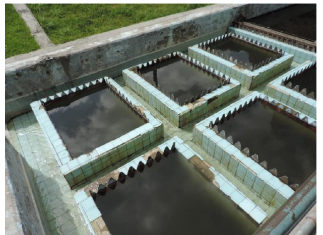
Fotografía 12. Tanques de contacto de cloro
