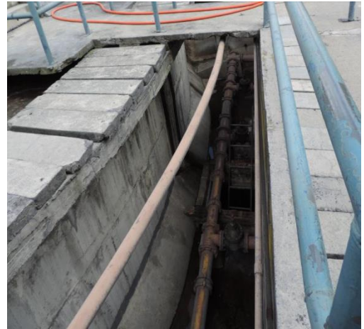
Fotografía 4. Tubería conducción de aire
