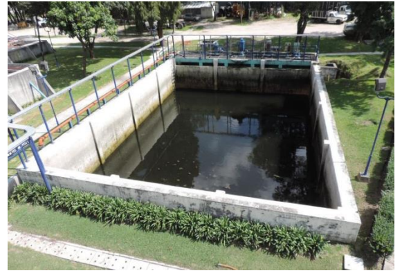
Fotografía 14. Cárcamo de almacenamiento
