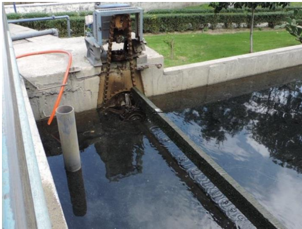
Fotografía 7. Equipo mecánico sedimentador Unidad de tratamiento 2
