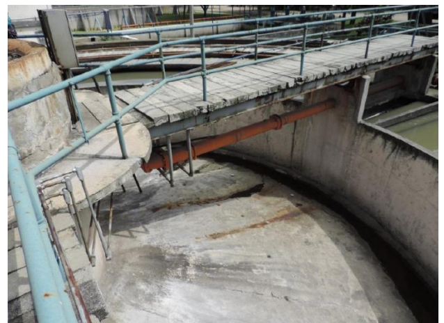
Fotografía 6. Grietas en digestor
