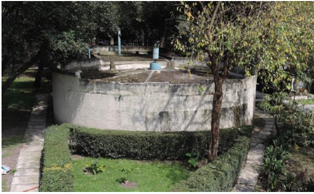
Fotografía 13. Digestores fuera de operación
