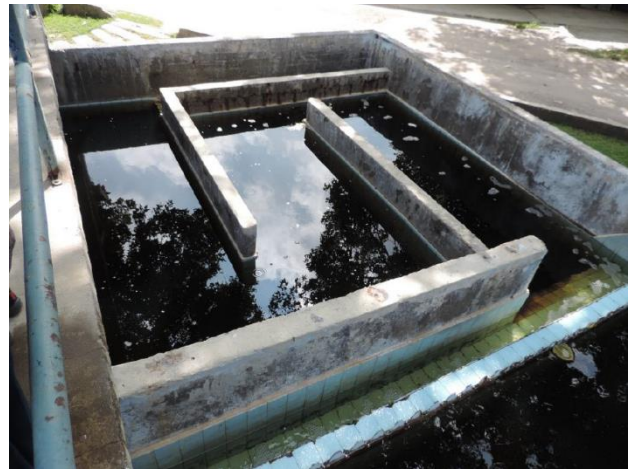
Fotografía 8. Tanque de contacto con cloro
