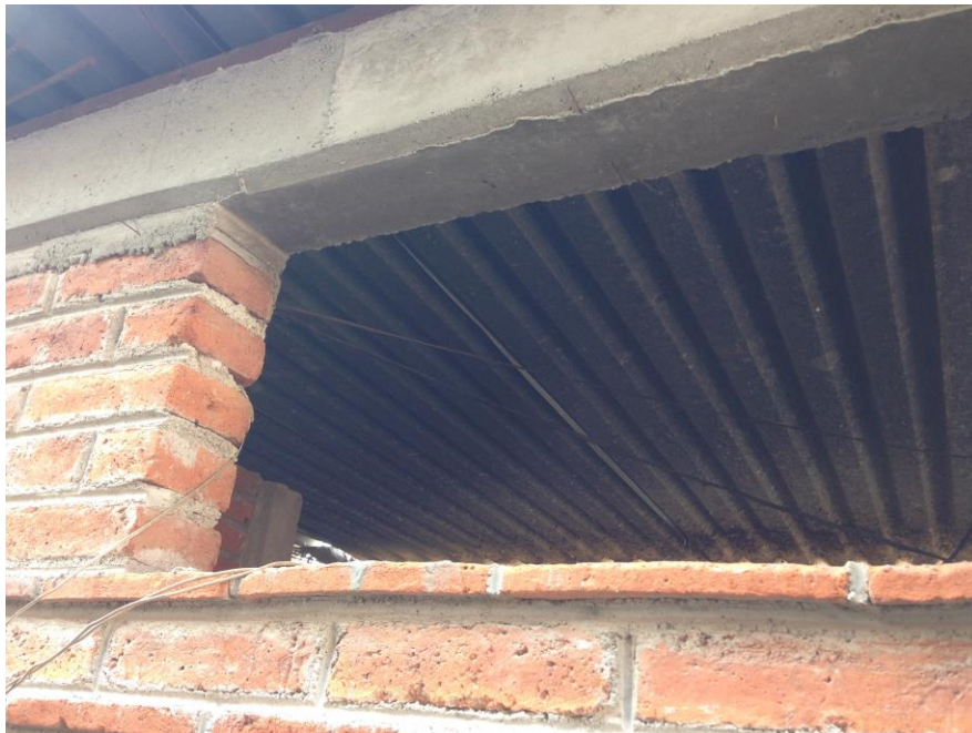
Figura 9. Ventanas del establecimiento sin protección contra insectos.
