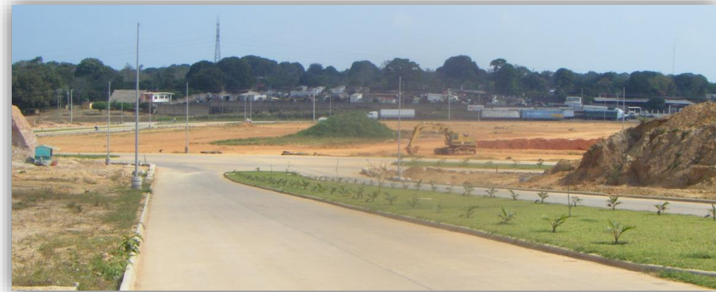
Vista al sur colindando con salida a carretera transistmica y desarrollo comercial, así como los postes de luces ya instaladas cada 25 metros de distancia uno de otro.
