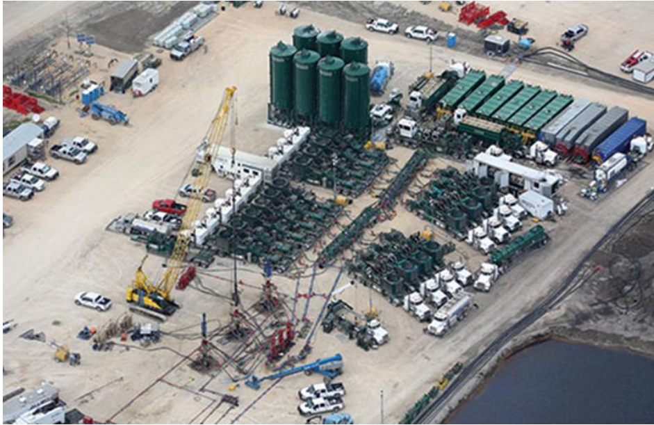
Figura 8.3 Macropera con Cabezales de Pozo Instalados Realizando una Actividad de Fracturamiento (Dominguez, 2013)
