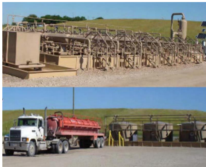
Figura 8.1 Separadores Bifásicos y Tanques de Almacenamiento de Agua (Mancini, et al., 2011)
