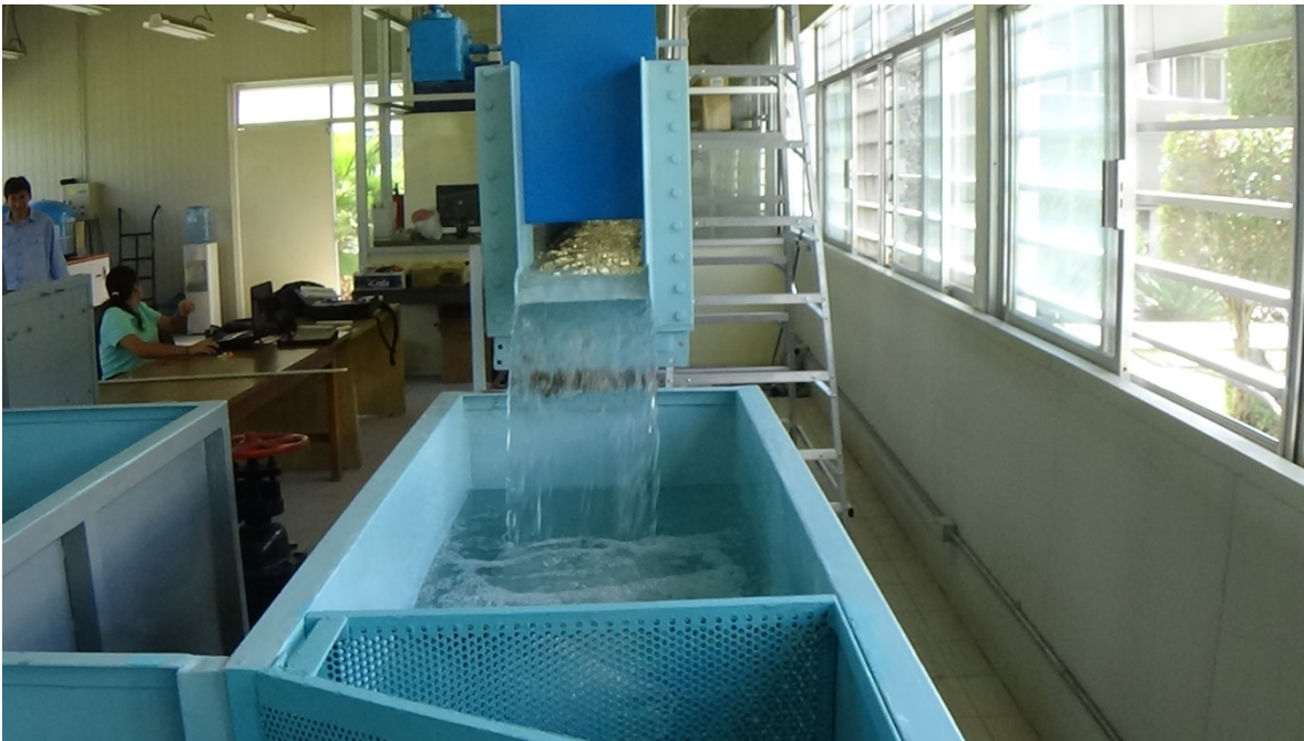
Figura 3.26.- Compuerta instalada, sin interacción con el agua
