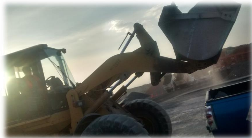
Figura 2.3. Carga y acarreo de agregados reciclado, Concretos Reciclados S.A. de C.V. Fuente: Elaborado por el autor.
