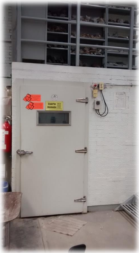
Figura 2.38. Cuarto húmedo de los laboratorios de Ingeniería de la FES Acatlán, UNAM. Fuente: Elaborado por el autor.
