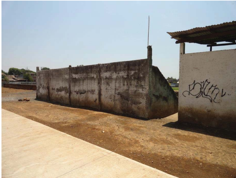
Imagen 3.2. Bancas sin rehabilitación.
