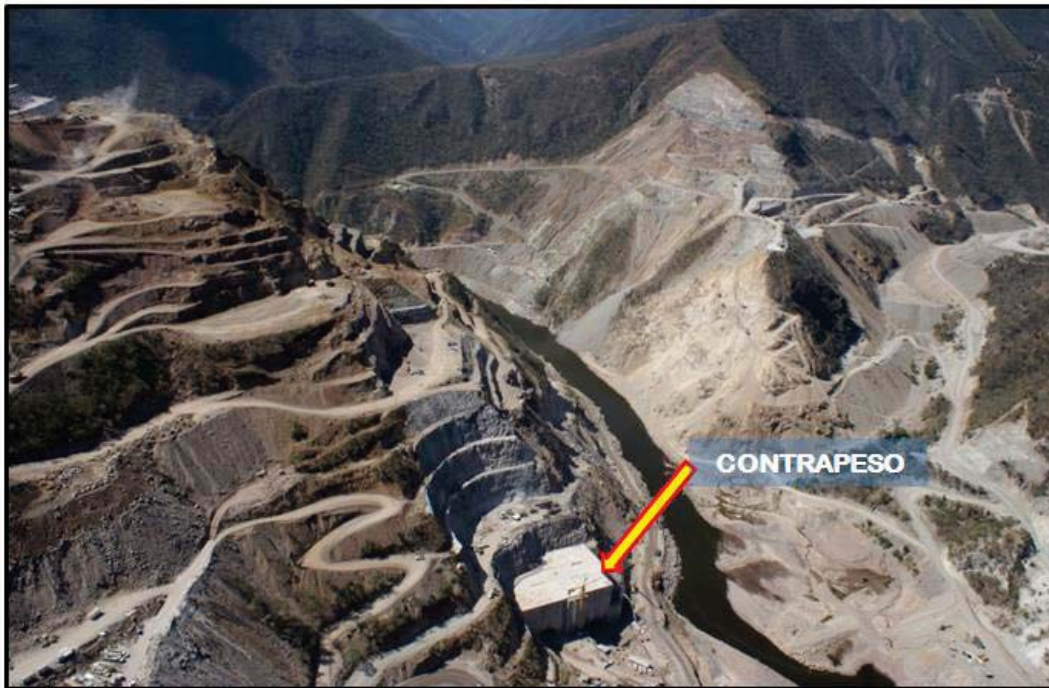
Figura 5. 71 Vista del Contrapeso.
