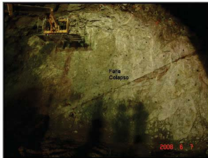
Figura 2. 3 Falla colapso en el túnel de desvío 1.
