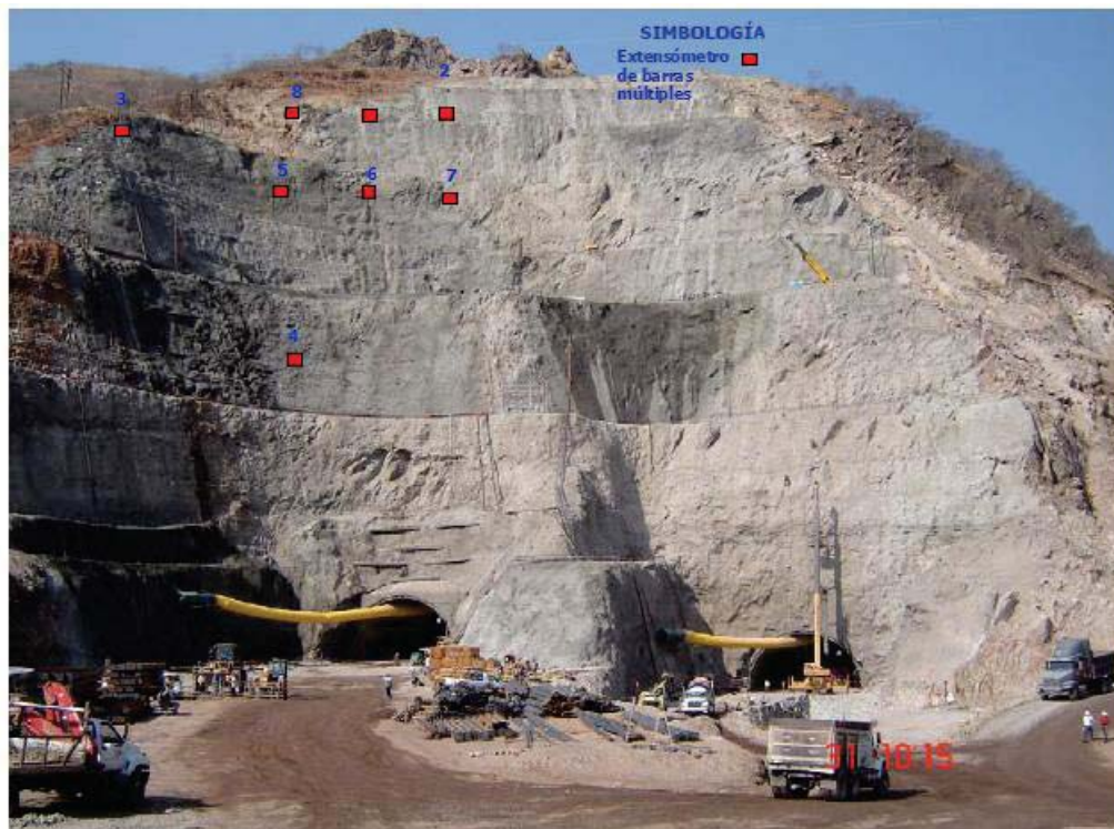
Figura 2. 13 Localización de los extensómetros de barra, primera etapa.
