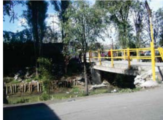
Figura 5.6 Obstrucción parcial en canales.
