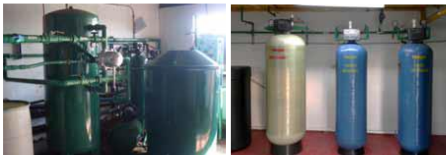
Figura 12. Suavizador de aguas antes (izquierda), tren de filtrado actual (derecha) de la cadena de restaurantes del grupo.
