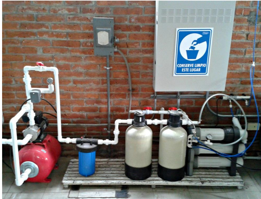
Figura A3. Equipo de tratamiento de agua en la Planta Solar.
