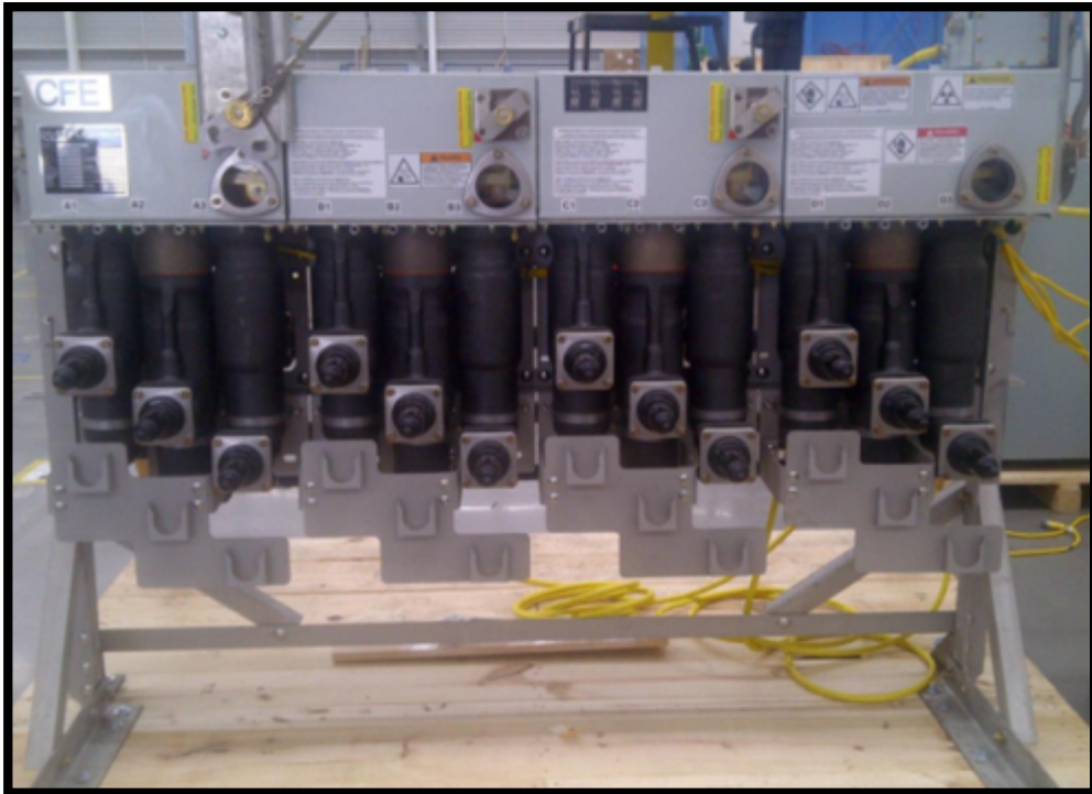
Figura 3.8 Equipo primario de seccionador subterráneo de 4 vías operando en la DVMC.
