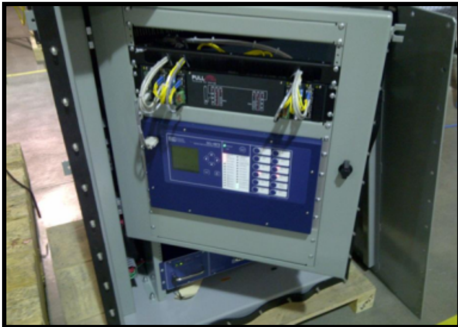
Figura 3.9 Gabinete de control de seccionador subterráneo de 4 vías operando en la DVMC.
