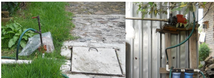
Figura 8. Bombas eléctricas para transportar el agua de la cisterna al uso final en un SCALL de Isla Urbana.
