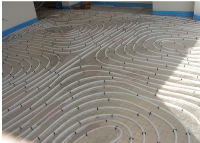
Imagen 19. Instalación de los colectores, conectando todos los circuitos de forma ordenada. Fuente: Funcosa, 2014.
