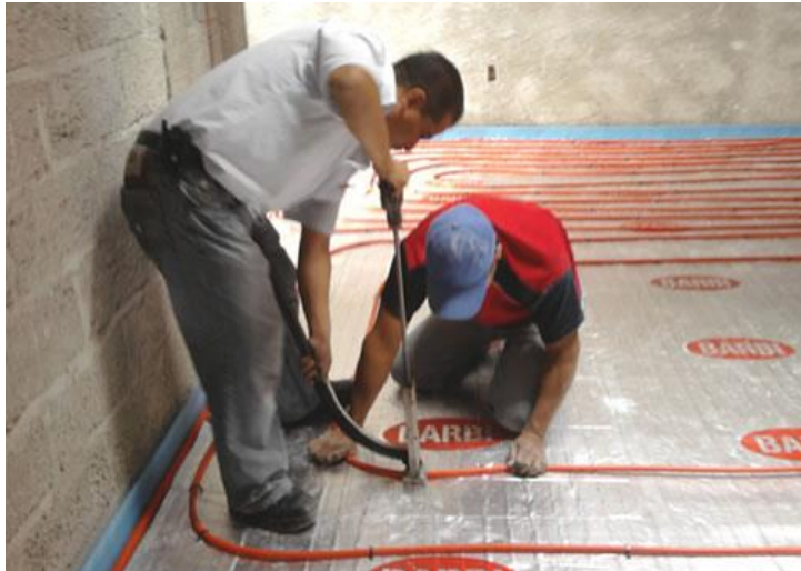
Imagen 18. Instalación de la tubería en la forma que se desea. Fuente: Funcosa, 2014.
