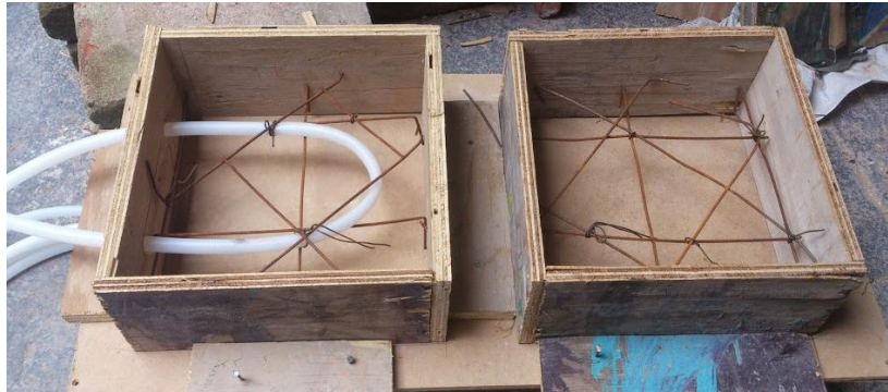
Imagen 43. Colocación de la tubería y de la varilla de refuerzo. Fuente: Autoría propia, 2014.
