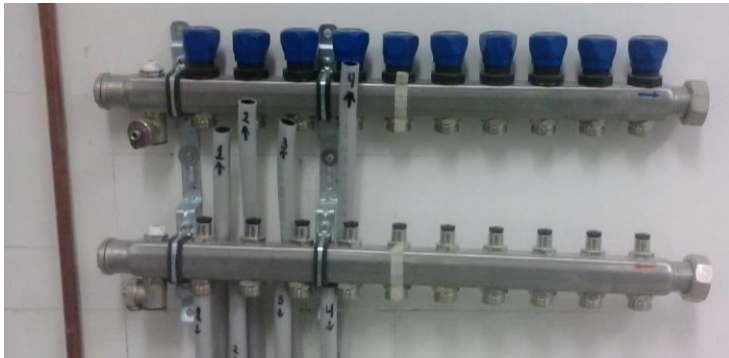
Imagen 22. Colector de distribución del piso radiante, mostrando la conexión individual de los tubos de polietileno. Fuente: Autoría propia.
