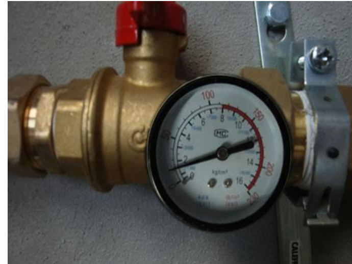
Imagen 20. Realización de la prueba de presión para asegurar que no existan fugas en la instalación. Fuente: Funcosa, 2014.
