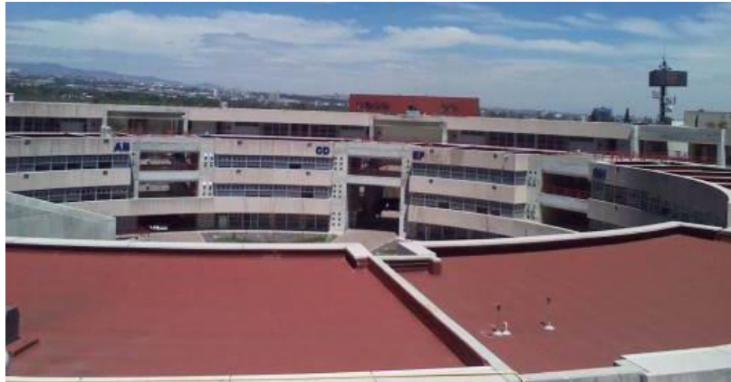
Imagen 26. Vista de la azotea del edificio J de la Unidad de Posgrados. Fuente: Autoría propia, 2014.
