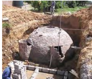
Figura 4.25 Digestor de domo fijo en una comunidad del sur de África.
