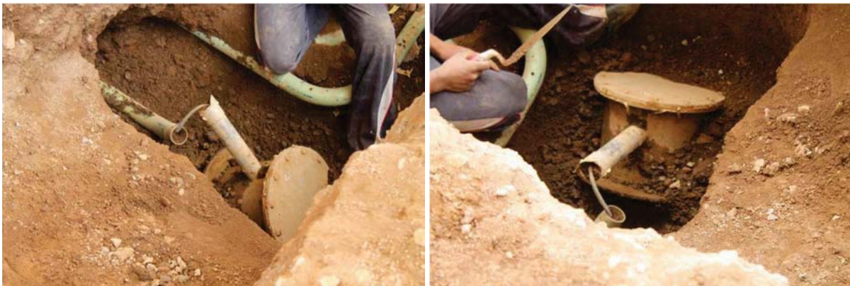
Fig 5.31 Detalle del contenedor de los sensores de aceleración arrancado de la zapata de la columna C5
