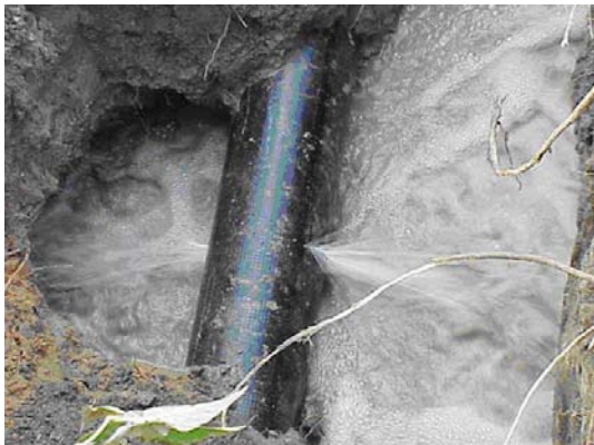
Ilustración 7. Fuga en tubería. FUENTE: Alliance for Water Efficiency, 2010. Recuperada de: http://www.allianceforwaterefficiency.org/Water_Loss_Control_-_What_Can_Be_Done.aspx
