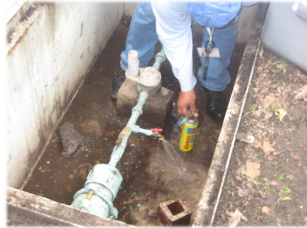
Ilustración 11. Toma de muestras para análisis de calidad del agua en Edificios 2, 3 y 4: Toma de la red principal, ubicada debajo del puente que une a estos edificios. FUENTE: Elaboración propia.
