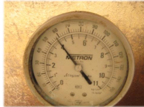
Ilustración 12. Lectura de 4 kg/cm 2 en el manómetro de carátula cercano al crucero 91. FUENTE: Elaboración propia.
