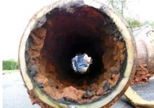
Ilustración 6. Corrosión. FUENTE: EPA, 2014. Recuperado de: http://www.epa.gov/awi/publications.html
