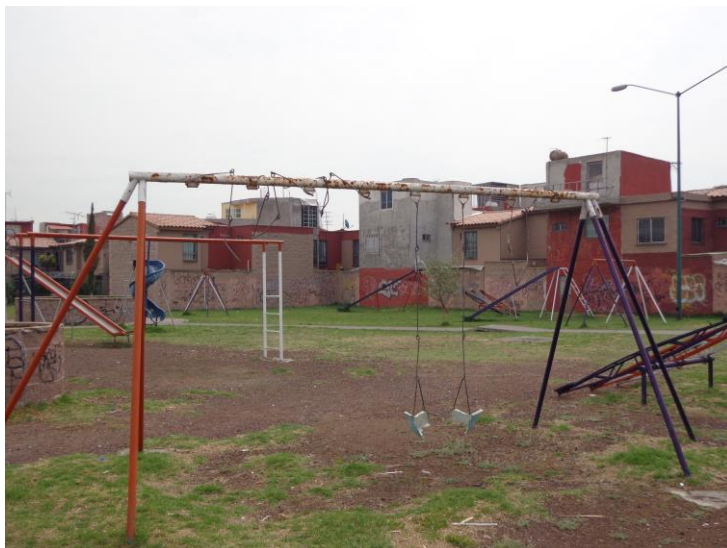
Imagen 31: Área verde en mal estado, conjunto urbano Geovillas San Mateo II-Independencia , mpio. de Toluca.
