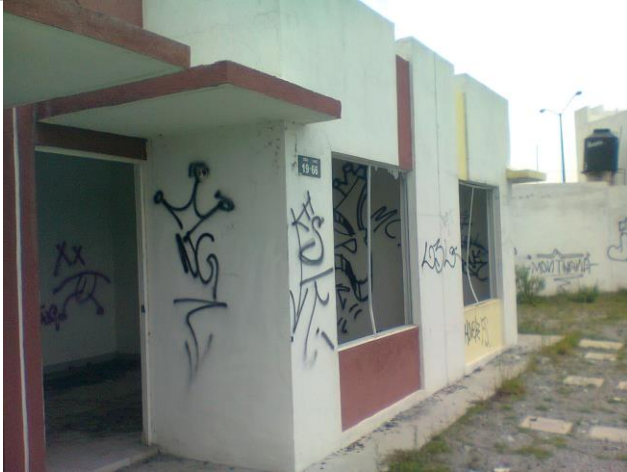
Imagen 47: Viviendas vandalizadas en conjunto Valle del Nevado , mpio. de Calimaya.
