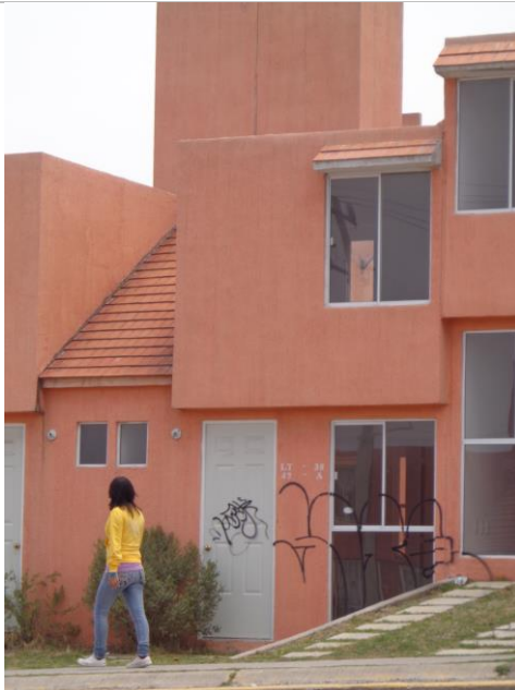
Imagen 49: Vivienda seminueva vandalizada. conjunto Colinas del Sol , mpio. de Almoloya de Juárez.
