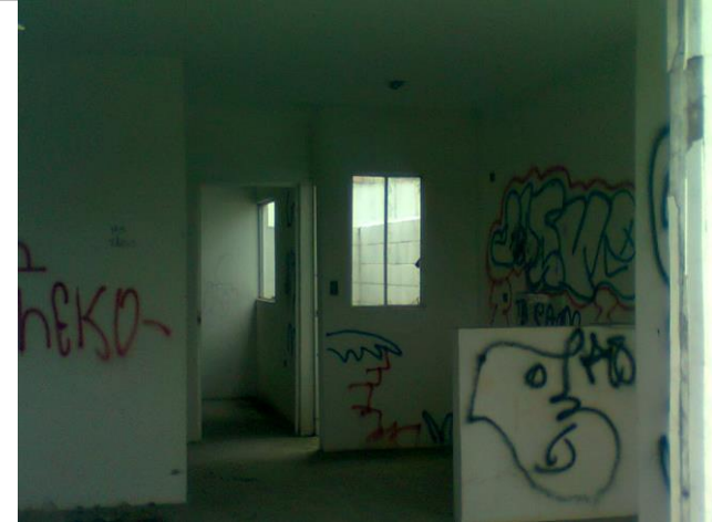
Imagen 48: Interior de vivienda vandalizada en conjunto Valle del Nevado , mpio. de Calimaya.
