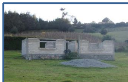
Figura 19. Construcción de casas alrededor de la reserva
