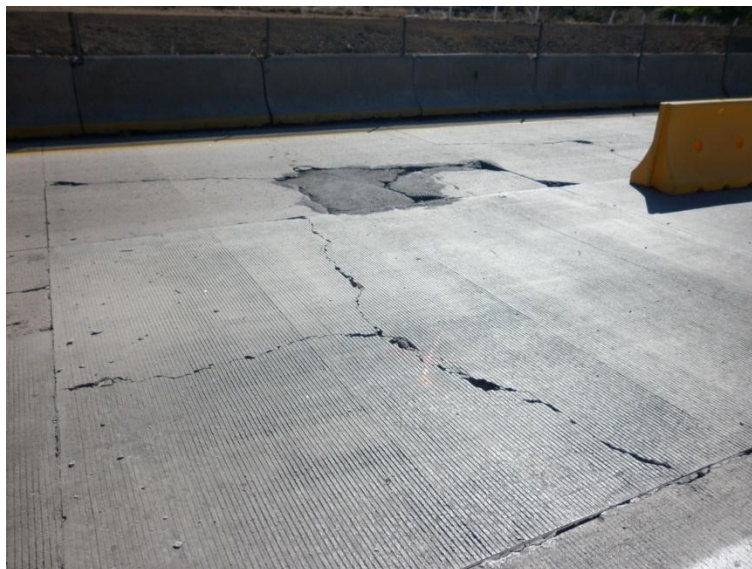
Fotografía 2.4 Losa de concreto con falla.
