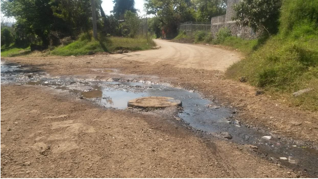
Imagen 3.10.- Esgurrimiento del agua.
