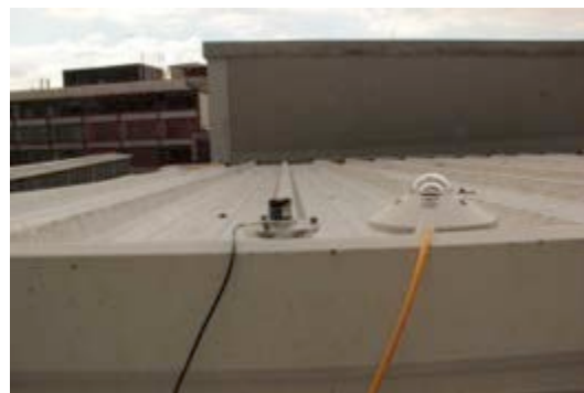
Fig. 15. Piranómetro No.1, Fotómetro No.24, sobre cubierta en azotea.
