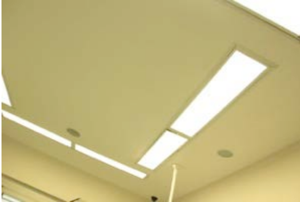
Fig. 7. Imagen del falso plafón del quirófano 4 (HOL) con iluminación generalizada (8 lámparas T8).
